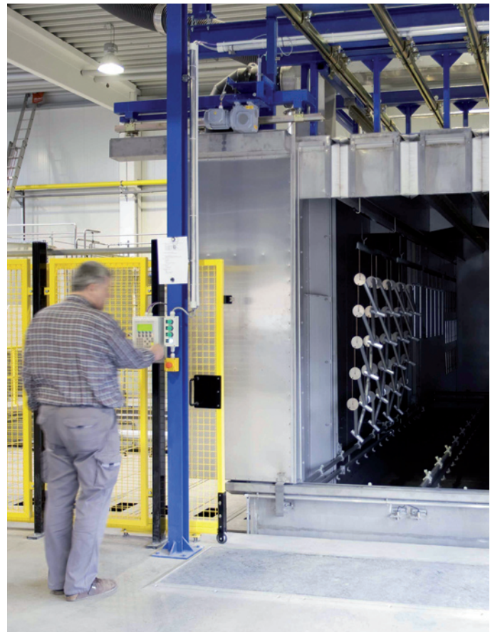
Blick in die Vorbehandlungskammer.
