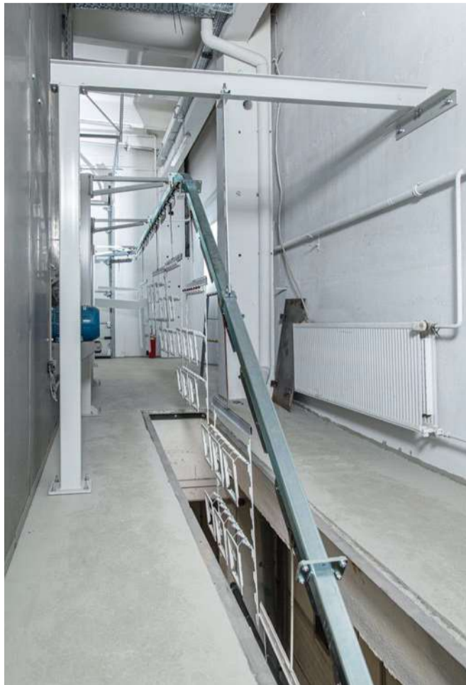
Dank neuer Schrägförderung ist nun die Anlagentechnik im Obergeschoss mit der Aufhängung im Erdgeschoss verbunden. Fotos: Noppel
