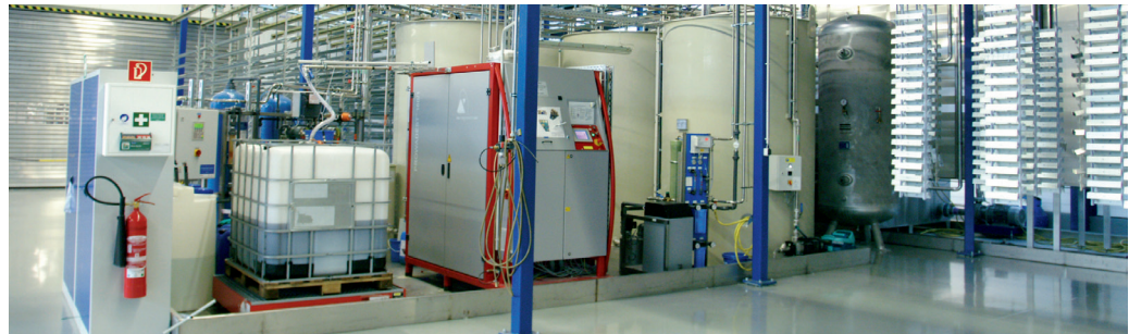
Die Vorbehandlungsanlage arbeitet u.a. durch den Einsatz einer Kreislaufanlage für das VE-Wasser und einer Vakuum-Destillationsanlage abwasserfrei.
