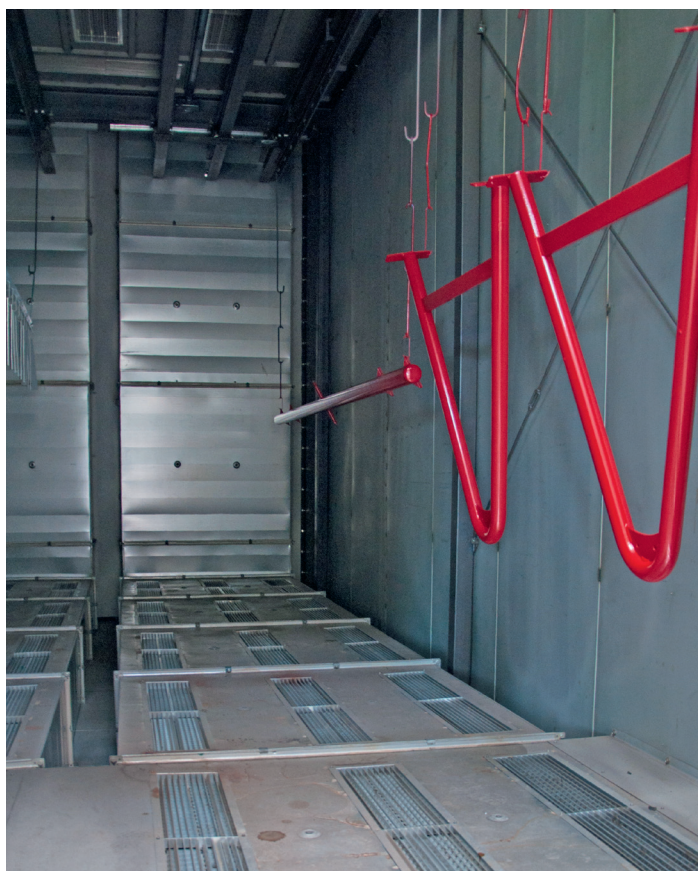
Die Luftführung im Pulverofen erfolgt vertikal. Unterschiedliche Farbtöne – wie hier grau und rot – können so zusammen in einem Ofen eingebrannt werden. Zudem ist die Bauteilerwärmung sehr homogen.
