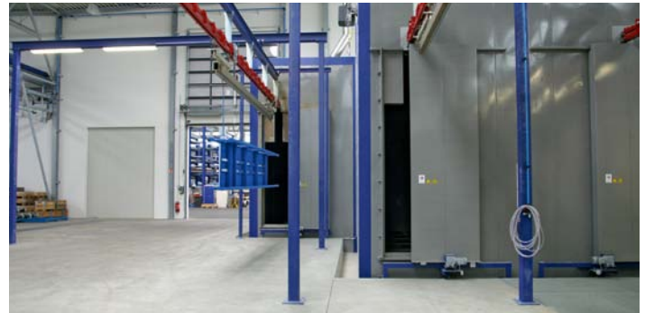
Der Haftwassertrockner (rechts) ist mit dem Einbrennofen (links im Hintergrund) kombiniert. Quelle (zwei Fotos): Redaktion
