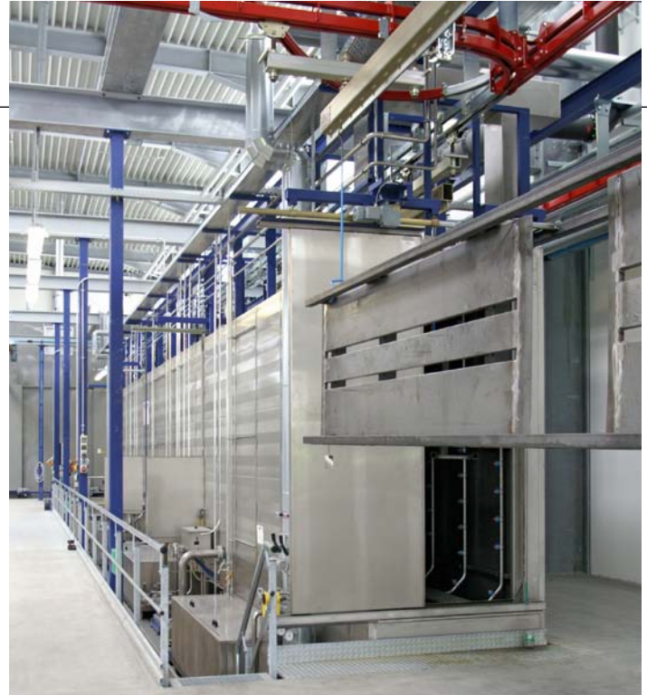
Die 3-Kammer-Vorbehandlung umfasst die Arbeitsgänge Beizentfetten, Spülen und Passivieren.
