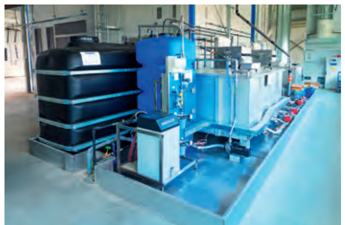
Im Falle des Falles schützt eine Edelstahlwanne das Grundwasser.
