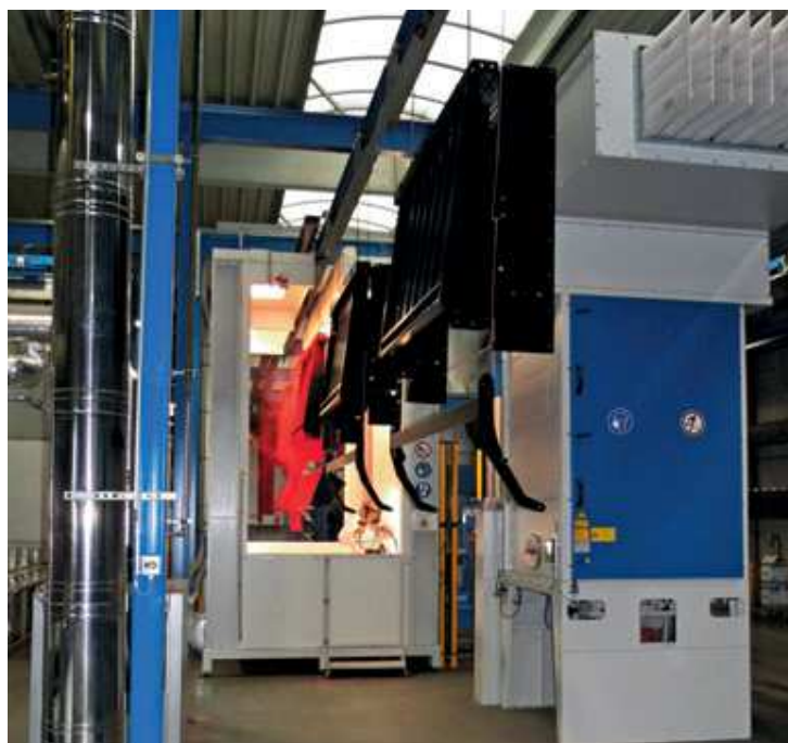
Die Pulverapplikation erfolgt manuell in einer Durchlaufkabine aus Kunststoff. Das Anlagenlayout ist so ausgelegt, dass bei Bedarf eine weitere Kabine installiert werden kann. Quelle: Redaktion
