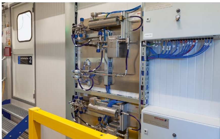
Moderne Lackmischtechnik an der Rückseite der Lackierkabine.
