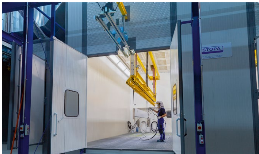
Hub-Senkrichtungen stehen auch in den Lackierkabinen zur Verfügung.
