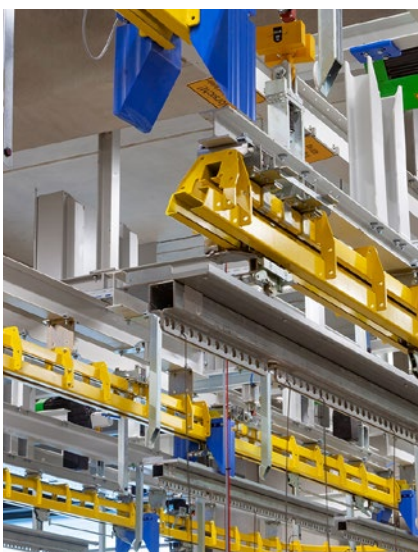
Um Flexibilität im Arbeitsablauf zu erreichen, wird der Materialfluss von einer Power & Free-Förderanlage übernommen.
