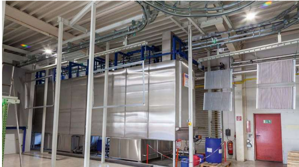
In der 4-Kammer-Multimetall-Vorbehandlungsanlage werden die Werkstücke vor der Pulverbeschichtung gereinigt und vorbehandelt.
