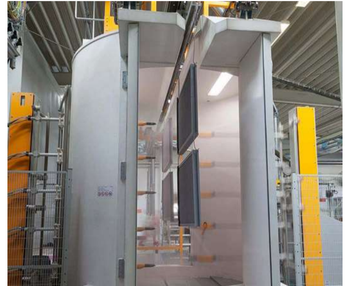
Die Pulverbeschichtung erfolgt in einer Schnell-Farbwechsel-Kunststoffkabine im Automatik- und/oder Handbetrieb.
