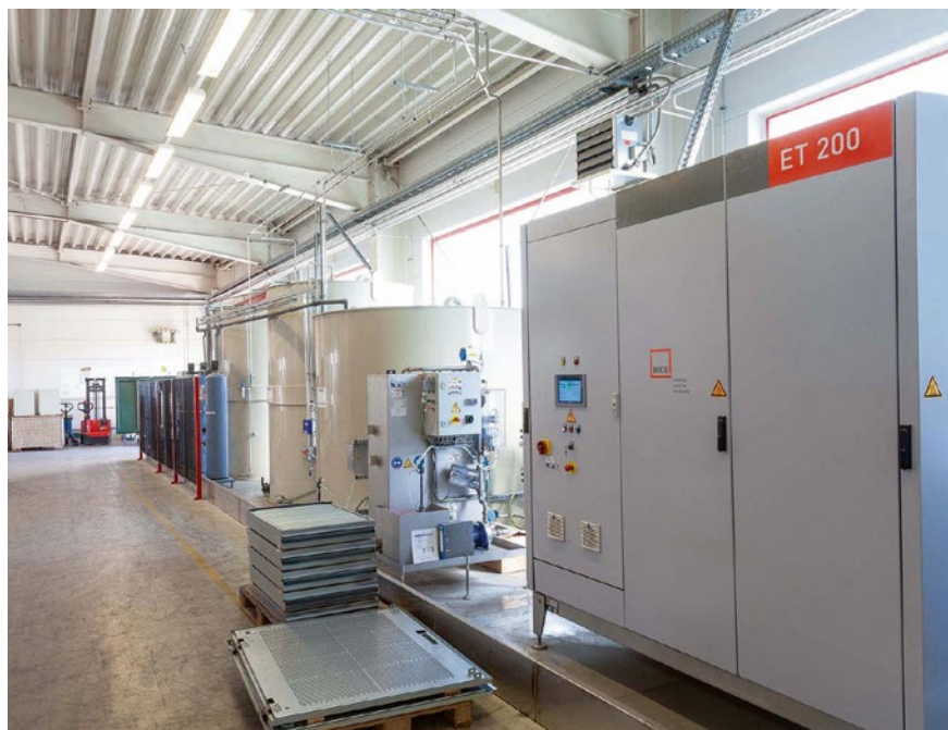
Die Wassertechnik: Als umweltfreundliche Lösung wurde ein System aus Frisch-, Kreislauf-VE- und Verdampfer-Anlagentechnik installiert.
