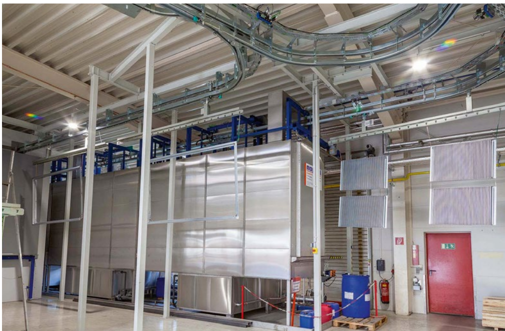
In der 4-Kammer-Multimetall-Vorbehandlungsanlage werden die Werkstücke vor der Pulverbeschichtung gereinigt und vorbehandelt, sie ist flexibel erweiterbar.
