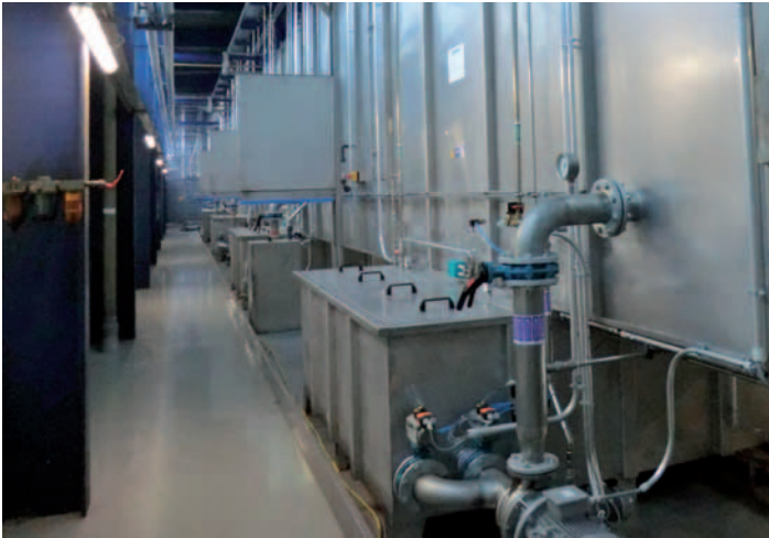
Die Fünf-Kammer-Vorbehandlungsanlage ermöglicht die Bearbeitung von Werkstücken aus unterschiedlichsten Materialien. Insgesamt ist die Anlage rund 200 Meter lang.
