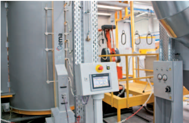
Die Steuereinheit für die gesamte Anlagentechnik von der Vorbehandlung über die Fördertechnik bis zum Einbrennofen wurde wegeünstig direkt hinter der Pulverkabine an einem Prüfplatz zusammengefasst.
