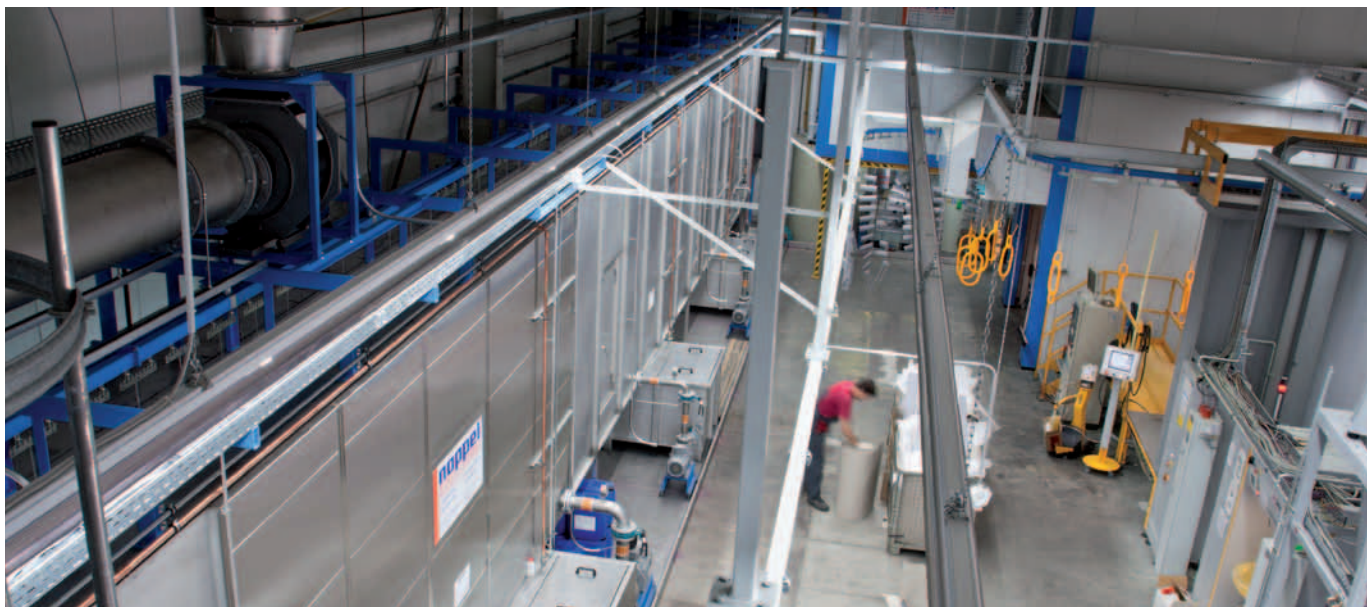
Fast die gesamte Längsseite der 30 Meter langen Hallenwand nimmt die Vorbehandlungsanlage (links) ein. Rechts vorne ist die Pulverküche zu sehen, dahinter der Auslauf aus der Pulverkabine. Die frisch beschichteten, gelben Kettenringglieder fahren in den 200°C heißen Einbrennofen.
