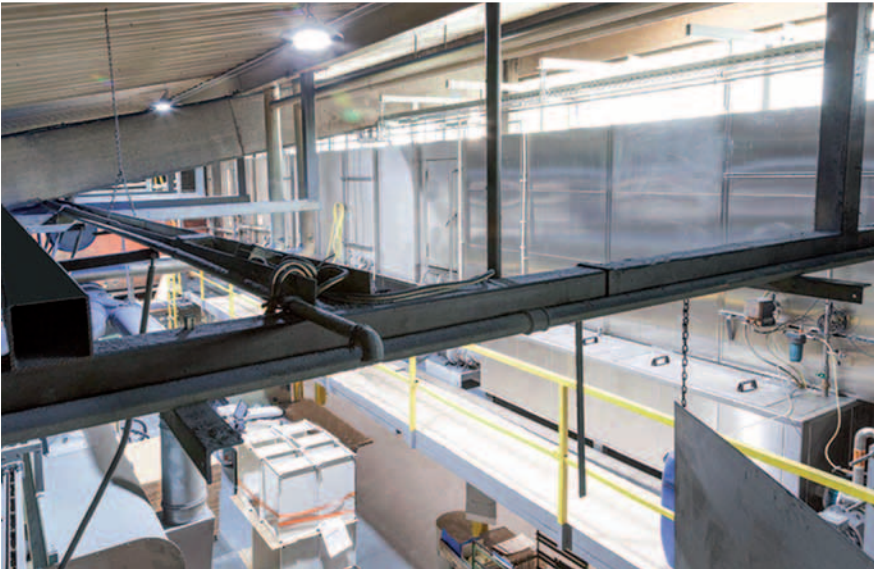
Die Vorbehandlung zog mangels Platz in den ersten Stock. Das machte eine Verstärkung des Stahlbaus notwendig.
