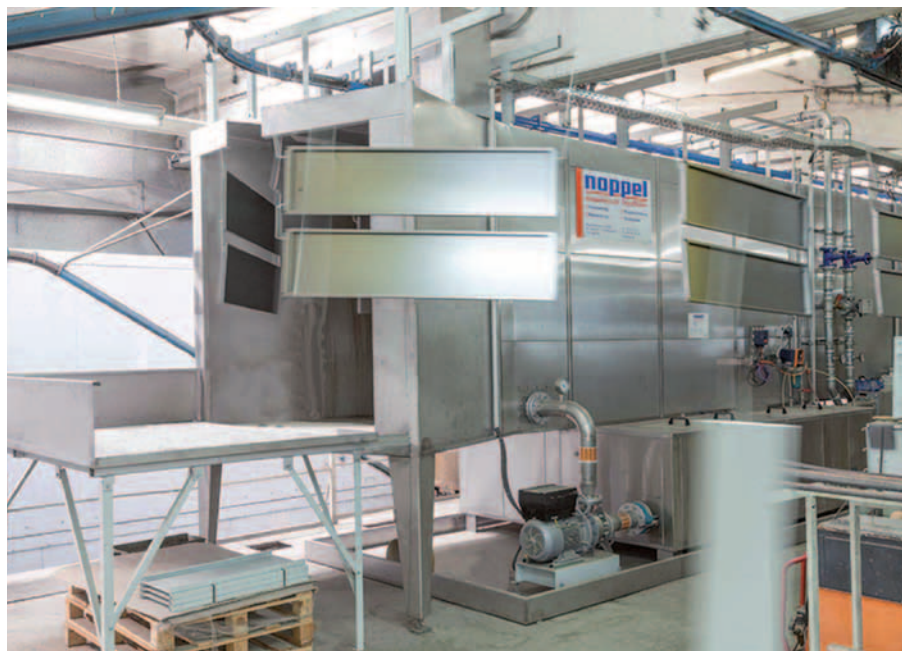
In Moosbach konnte die neue Vorbehandlung ebenerdig installiert werden und erfüllt alle Forderungen nach Effektivität und Nachhaltigkeit.
