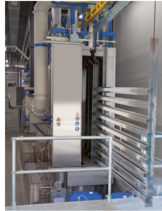
Schiebetüren dichten während der Vorbehandlung die einzelnen Behandlungskammern ab.
