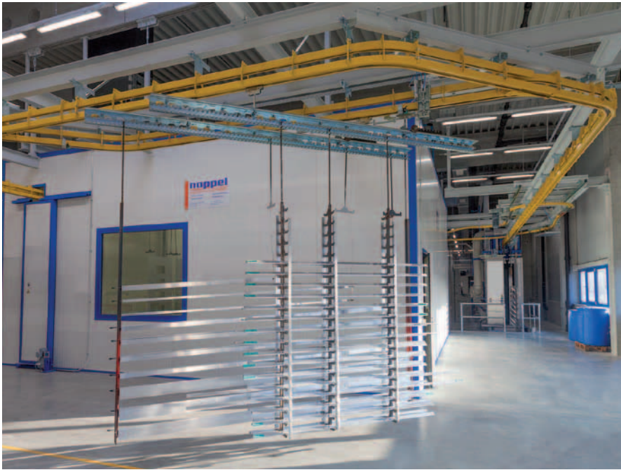
Profilteile auf dem Weg zur Vorbehandlungsanlage – Die Aluminiumteile werden von der Pulverbeschichtung nasschemisch gebeizt und passiviert, um eine optimale Haftung zu gewährleisten.
