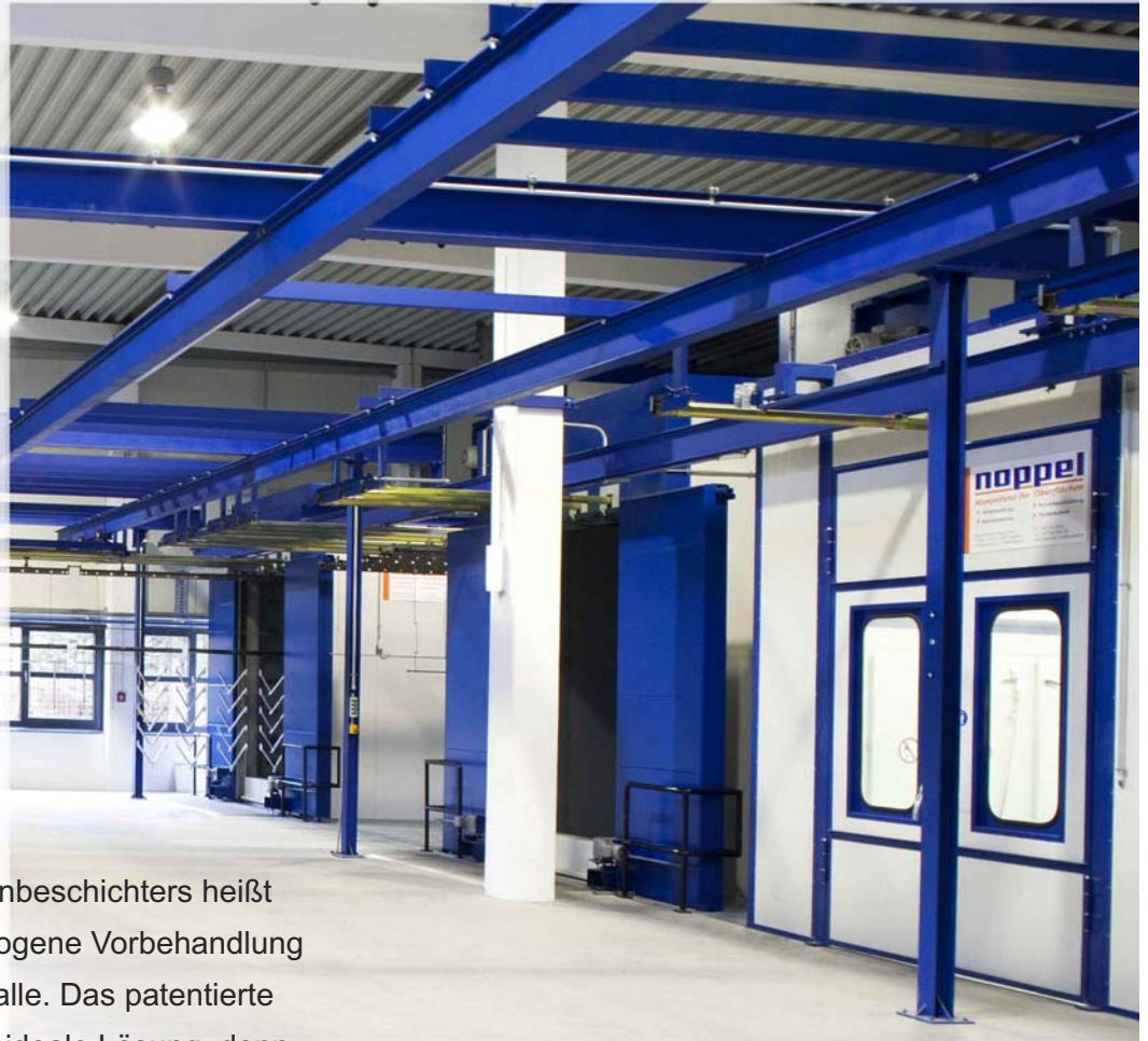
Pulverbereich mit Trockner, Abkühlpuffer, Pulverofen und Pulverkabine.
